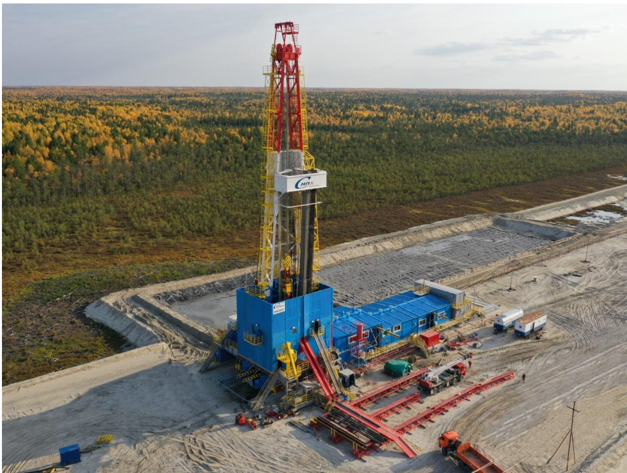
Рисунок 7.1 – Общий вид установки БУ 5000/320
