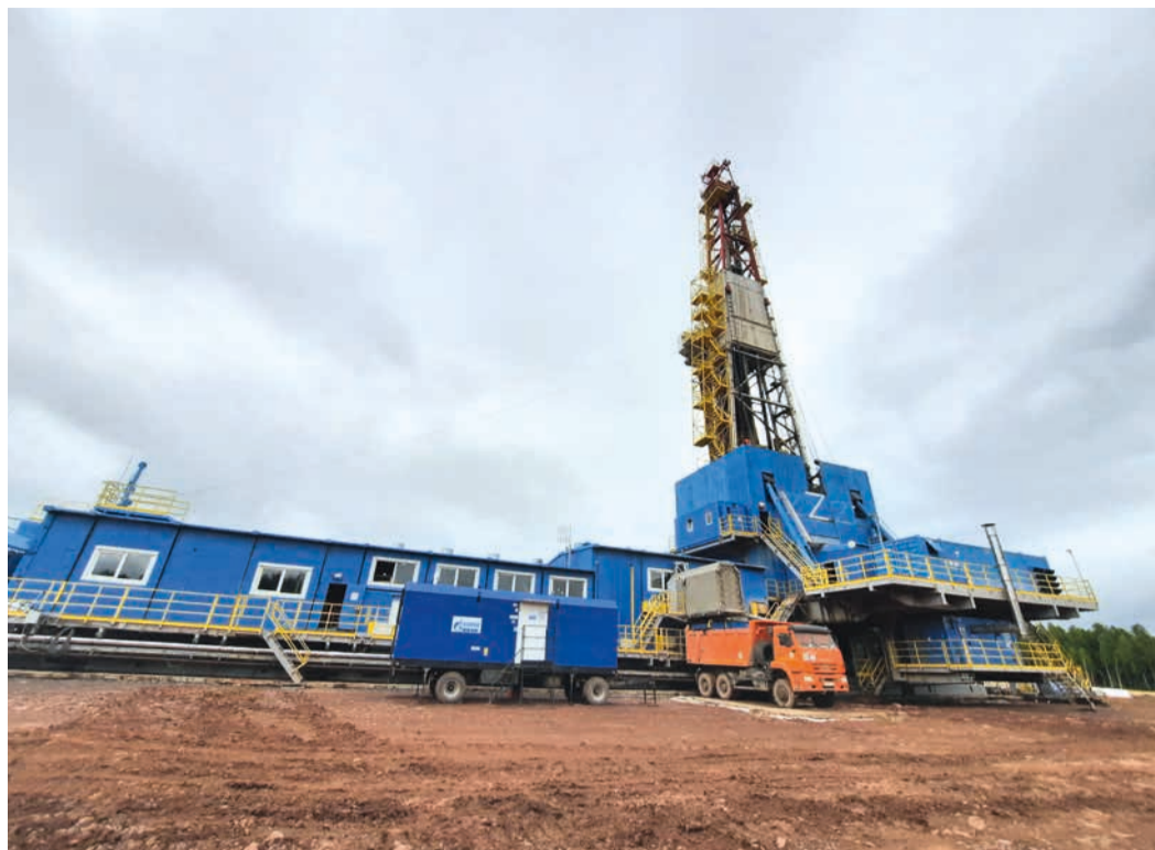
Скважина №5051 находится в пределах Хандинского ЛПУ в восточной части Ковыктинского ГКМ
