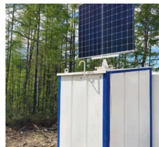
Система автономного энергоснабжения на магистральном газопроводе
