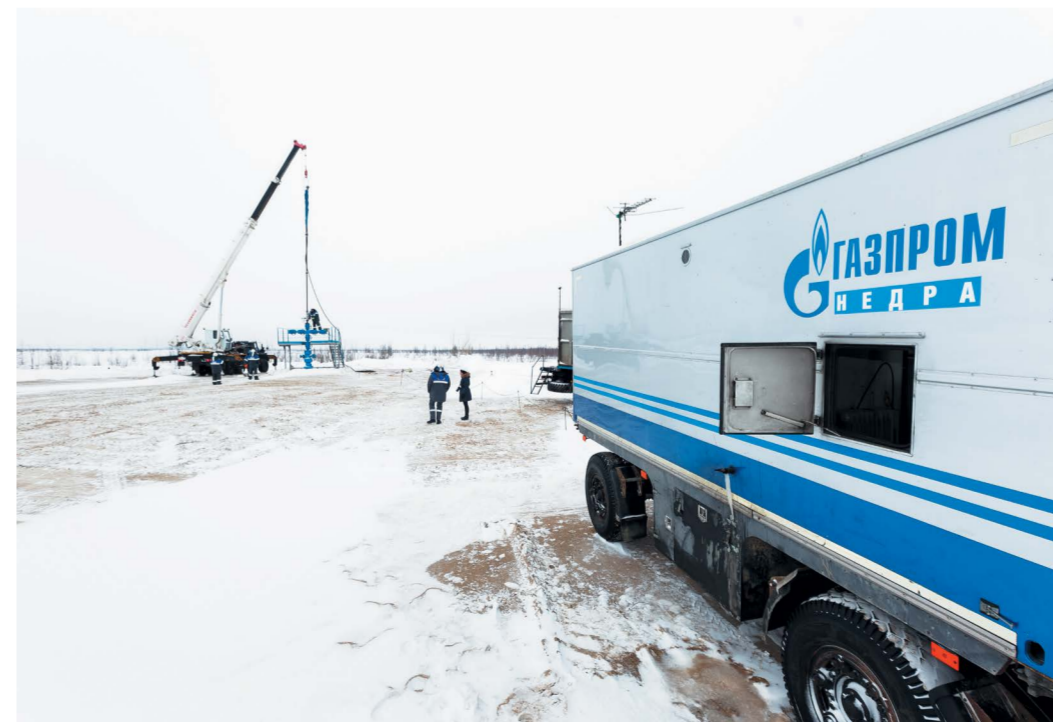
Производство ГИРС при контроле разработки месторождений ведется с использованием лубрикаторной установки для герметизации устья скважин производства НПФ «Центрзагеофизика»
